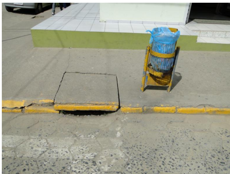
Figura 29 - Boca de Lobo tipo guia. Fonte: Visita Técnica STE, 2010.
