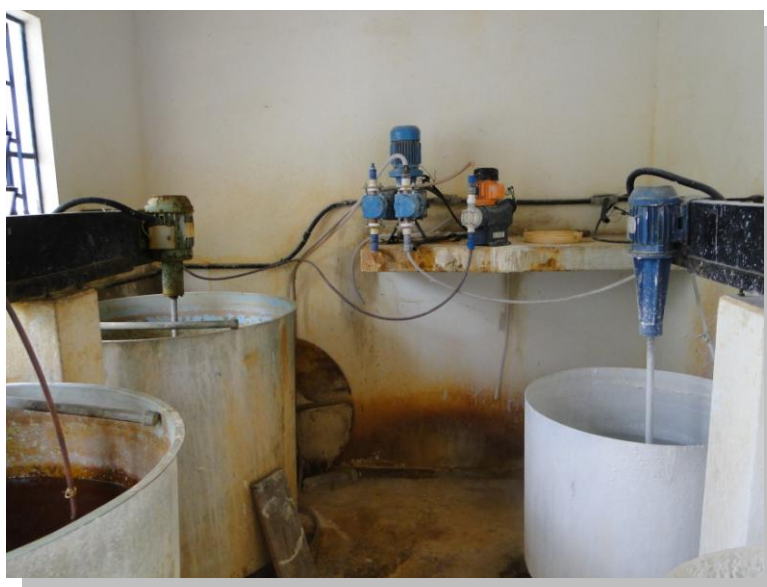
Figura 5 - Desinfecção com cloro e fluoretação em Tanque de contato. Fonte: Visita Técnica STE, 2010.
