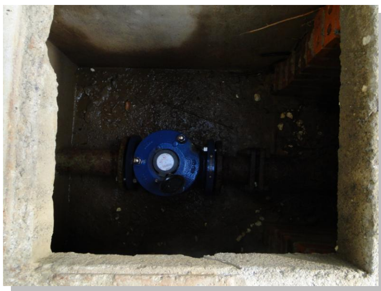
Figura 8 - Macro medidor. Fonte: Visita Técnica STE, 2010.
