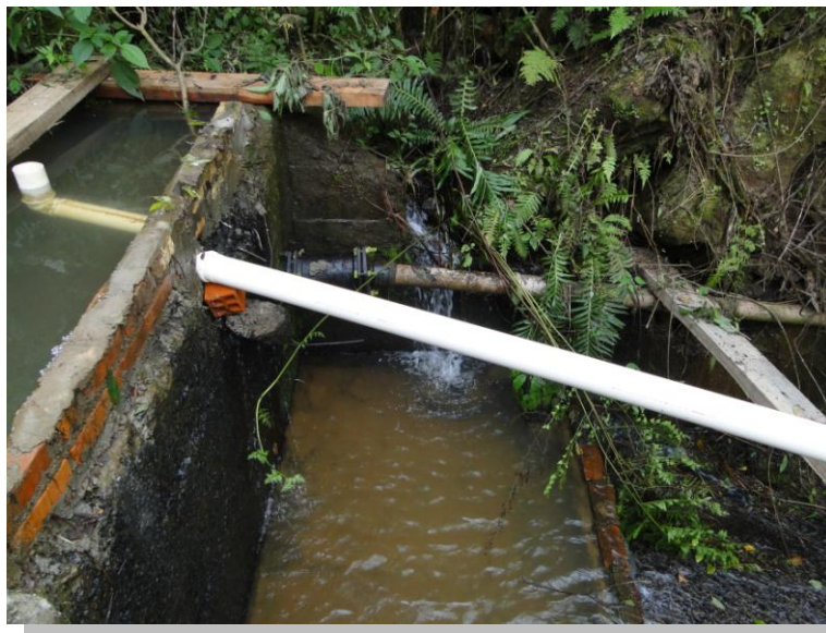
Figura 3 - Adutora de água bruta. Fonte: Visita Técnica STE, 2010.
