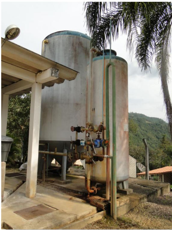
Figura 4 - Filtro. Fonte: Visita Técnica STE, 2010.
